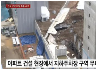
인천 검단 아파트 주차장 붕괴
